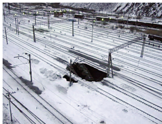
Провал частини залізничного полотна в порожнину під затопленими рудниками підприємства «Уралкалій».
