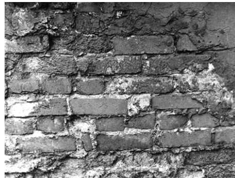
Відвал штукатурки, лущення і викрошування цегли цокольної частині стіни (за http:// georeconstruction.net/journals/04/09/09.htm ).
