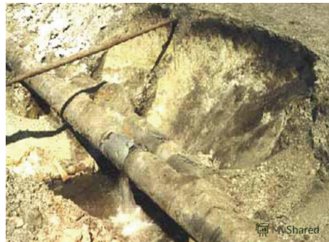
Суфозійне провалювання поверхні над магістральним трубопроводом (цитовано за http://www.myshared.ru/slide/1230934/ ).
