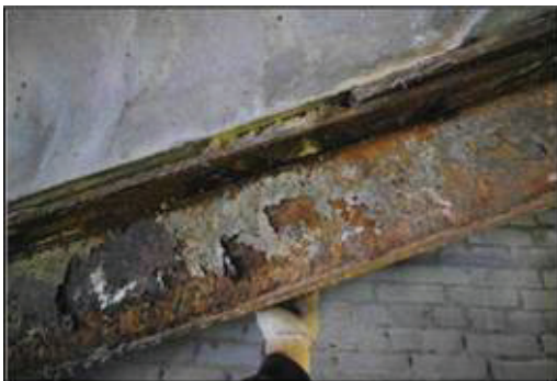
Корозійне пошкодження металеві конструкції (цитовано за http://art-con.ru/node/5020 ).
